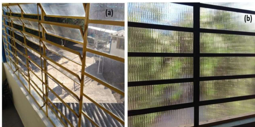
Figura 2: (a) janela com problemas de vedação (b) janela substituída pela APP.
